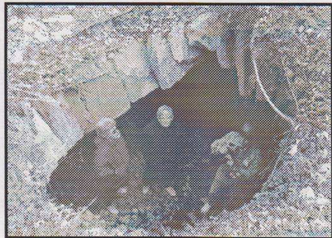
Hole in Butlers Run Culvert - Photo Brian Migliore
